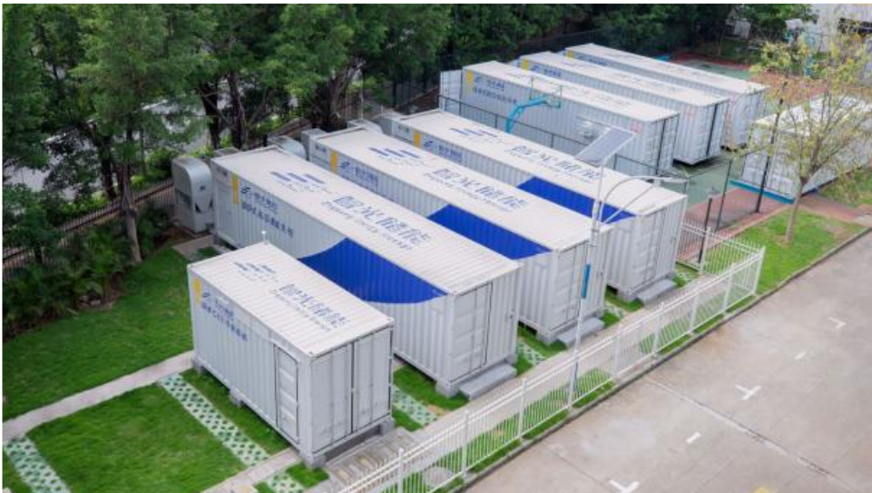
储能研究试验平台
