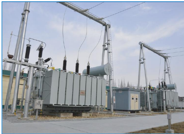
福建一炼油化工厂消弧改造项目
