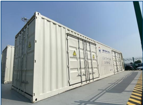
广州南沙岸电项目
