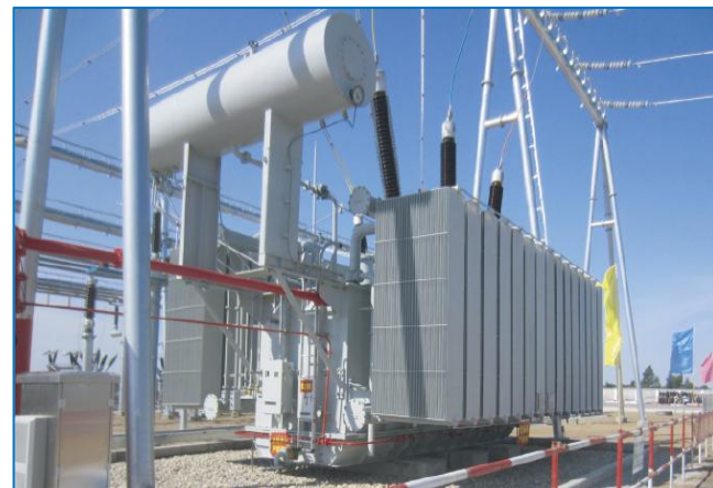
广东一变电站消弧改造项目
