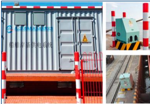
厦门港嵩屿岸电项目
